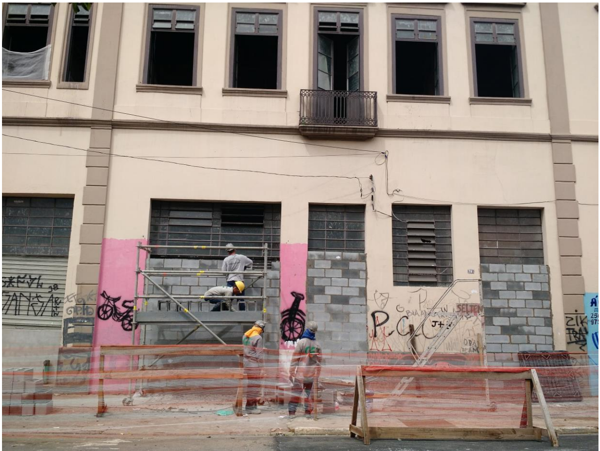
Interdição de imóveis na Quadra 36 em 15 de abril de 2018. Foto: Simone Gatti.
